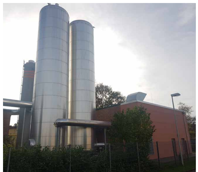
Abb. 9: Energiezentrale der Fernwärmeversorgung von den Stadtwerken Lübeck im Marliring
